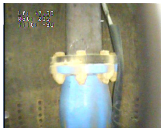
Haut de la pompe d'exploitation : 7,3 m/repère Début de la partie crépinée visible en arrière plan
