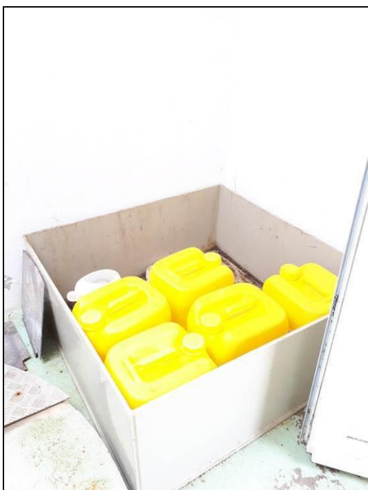
Stockage d'hypochlorite de sodium
