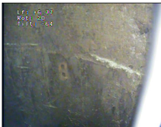
Premières crépines à partir de 6,7 m /repère
