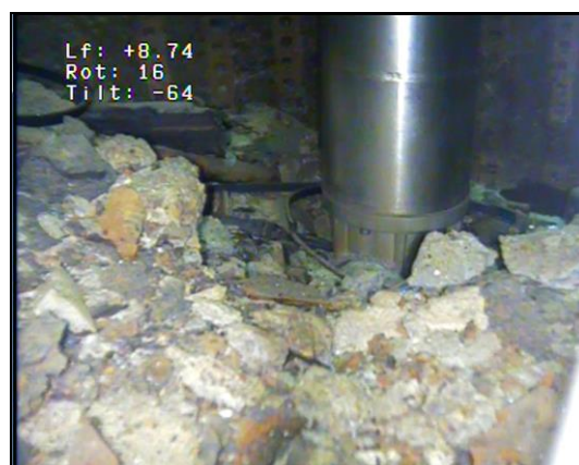
Fond du forage et pompe posée : 8,74 m/repère
